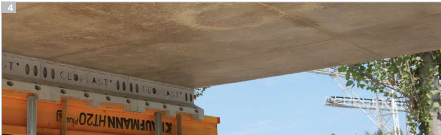
Efekt końcowy po ściągnięciu się betonu
